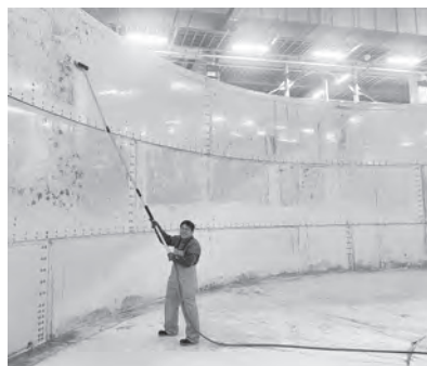
Proximar社の大型タンク
